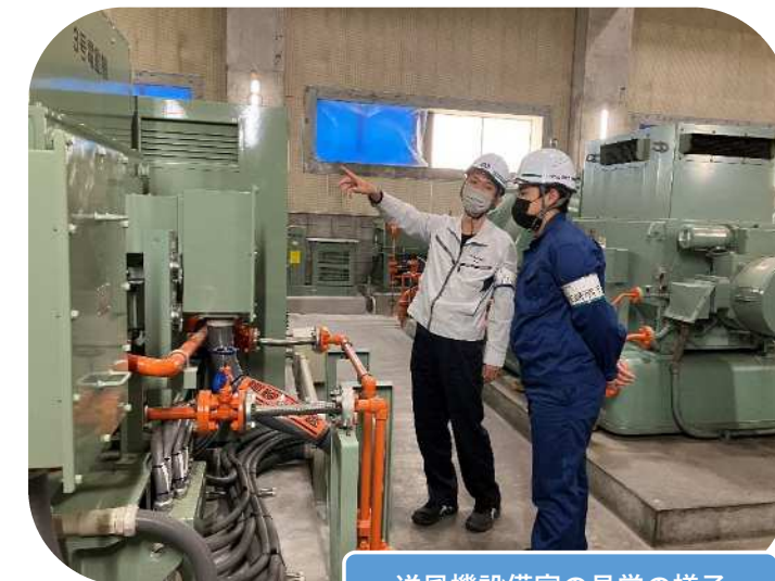
送風機設備室の見学の様子
